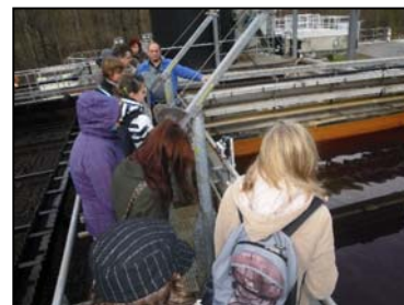
Obrázek 1: Gisbert Schöne (vedoucí úpravny vody [WBA]) vysvětluje u nádrží 2 metody selektivního srážení
